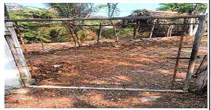
Foto 2: Se observa el portón en mal estado.
