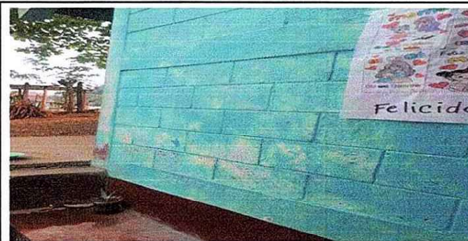
Foto 5: Se observa el deterioro de la pintura exterior.
