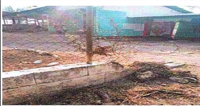
Foto 1: Se observa el predio en mal estado.
